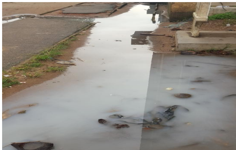
Photo 2 : Débordement d'une fosse sceptique au sein de la cite sogefiha (4 étages d'abobo)
