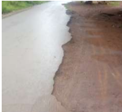
Photo 3 : Partie dégradée de la voie Toumbokro-Kossou
