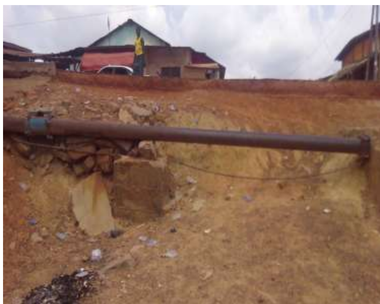
Photo 6 : Action de l'érosion sur une conduite d'eau potable à Adzopé
