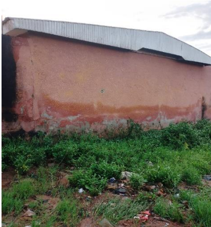
Photo 7. Des laisses sur un mur
