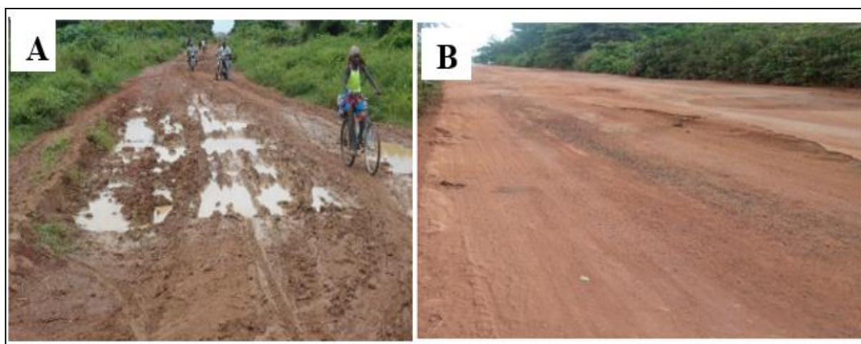
Photo 3: Infrastructure routière dégradante dans la région
