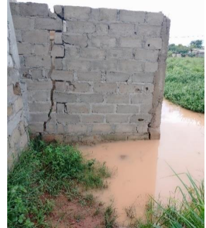
Photo 9. Inondation au (lit majeur) une cour habitée (lit mineur) pied d'un mur (lit majeur)
