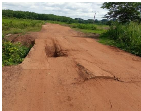
Photo 5 : Vue de l'état de route axe Gonaté-Gadouan
