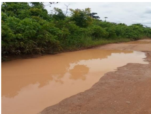
Photo 4 : Vue de l'état de la route axe Daloa-Bédiala
