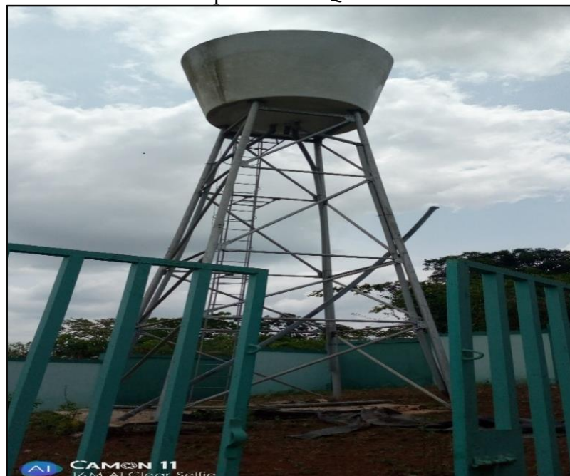
Photo 4: Château d'eau potable au Quartier Résidentiel
