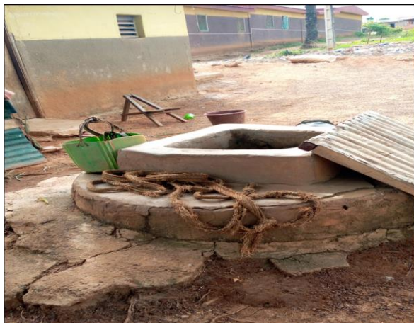
1a: Puit à ciel ouvert et dégradé à l'intérieur d'une cour au quartier Assayé 1
