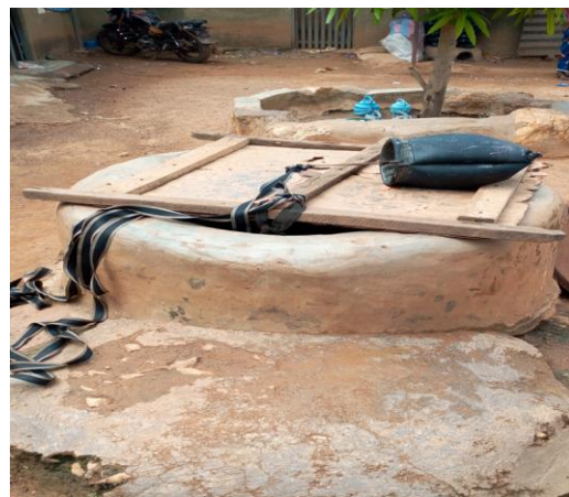
1b: Puit à ciel ouvert et dégradé au quartier Baoulé
