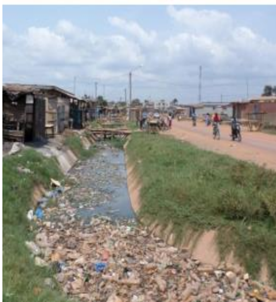
Photo 1 : Canal des eaux de pluie obstrué par les ordures à Bardo
