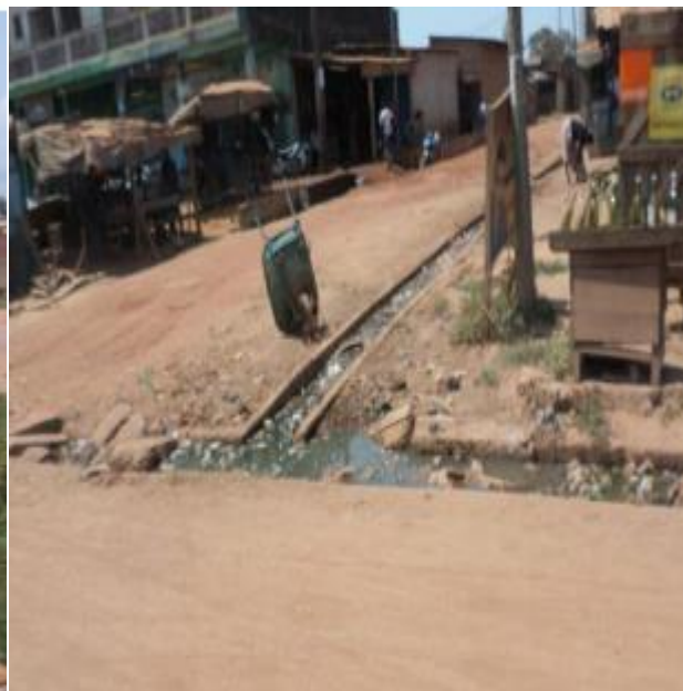
Photo 2 : Caniveaux des eaux pluviales mal entretenus à Séwéké (2018)
