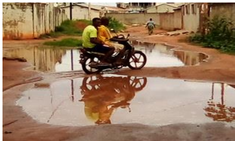
Photo 2 : État dégradé des voies à Abogomè
