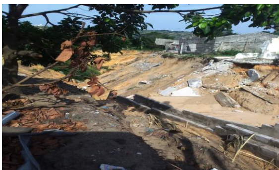
Construction menacée par l'érosion, rue Boya, Simba Pelle
