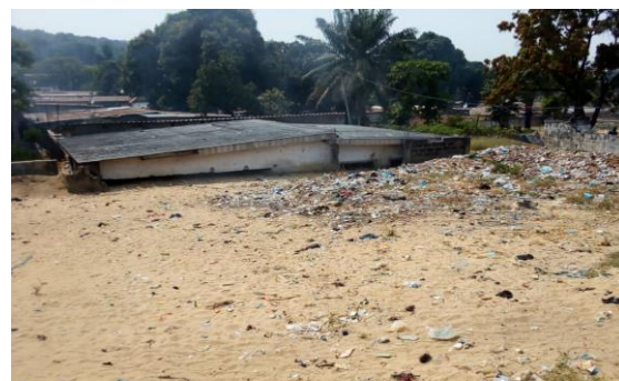
Habitation engloutie par le sable, rue Andzounou, Simba Pelle
