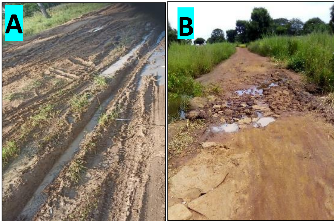
Photo 1 : planche de photos montrant des crevasses boueuses
