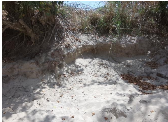
Photo 4b. Déstabilisation d'une berge par extraction
