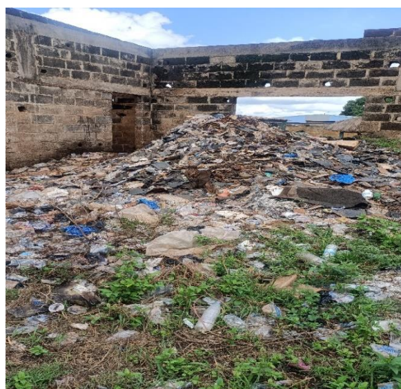
Photo 5 : Dépôt sauvage d'ordures dans une maison inachevée au quartier Diallo
