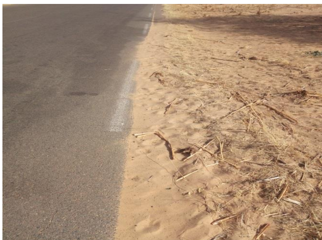
Photo 1 : Avancée d'un champ de mil sur l'emprise de la Route Nationale N°1 (Axe Zinder - Gouré)
