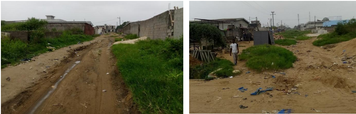
Photo 6 : Voies dégradées à l'intérieur du quartier PK 18
