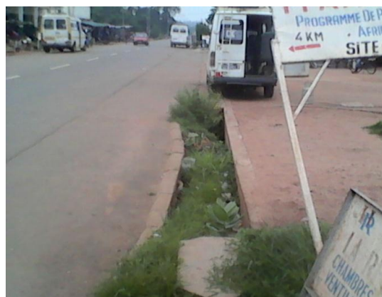
Photo 2 : Un caniveau obstrué au quartier Commerce
