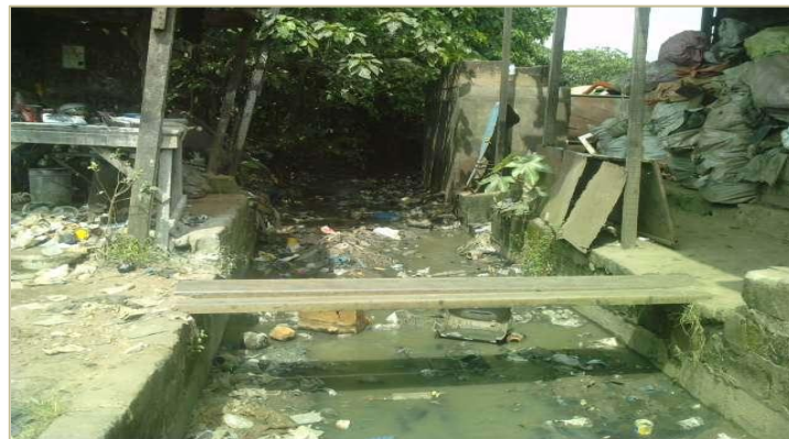
Photo 2 : Caniveau obstrué et jonché de déchets solides
