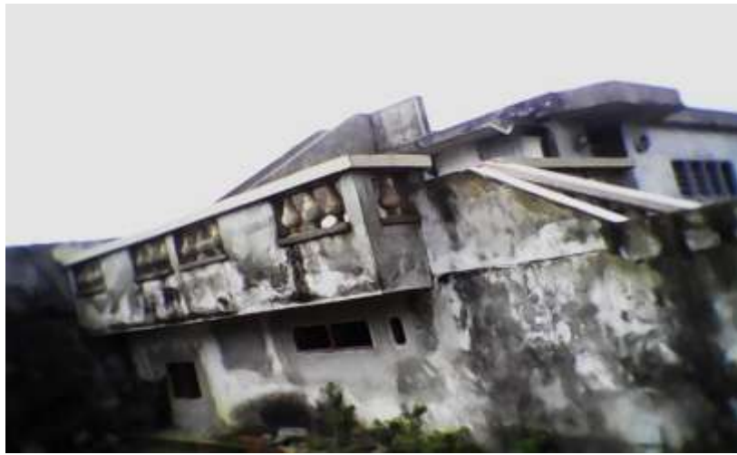
Photo 6 : Les murs délabrés de l'hôtel La Vallée au quartier Begnerie de Bonoua
