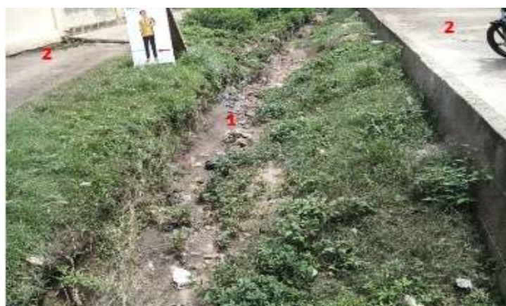
Photo 9 : Surcreusement de l'axe d'une rue (1) suite à l'aménagement de terrasses (2)
