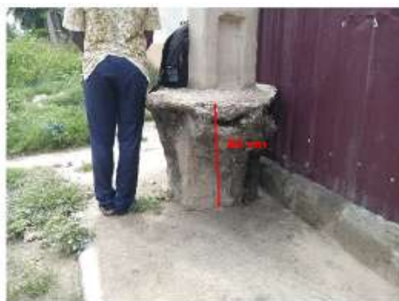
Photo 2 : Déchaussement d'un poteau
