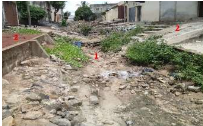
Photo 8 : Ravinement de l'axe de la rue (1) suite à l'aménagement des rampes et marches d'accès (2) aux maisons
