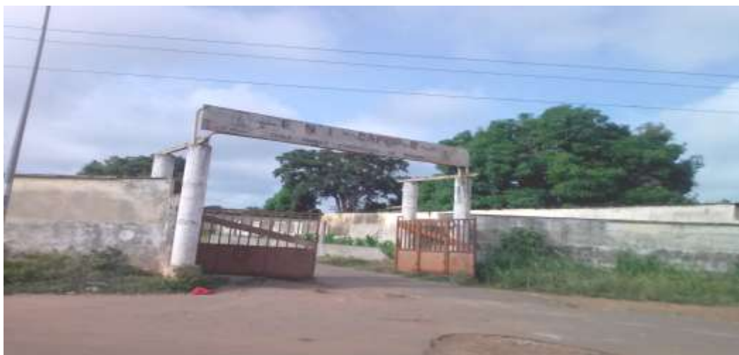
Photo 1 : Le CAFOP II de Bouaké détruit depuis la crise politico-militaire non encore réhabilité
