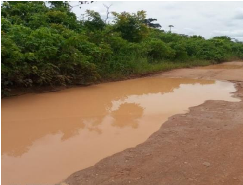
Photo 4 : Vue de l'état de la route axe Daloa-Bédiala
