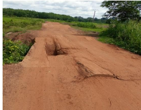
Photo 5 : Vue de l'état de route axe Gonaté-Gadouan
